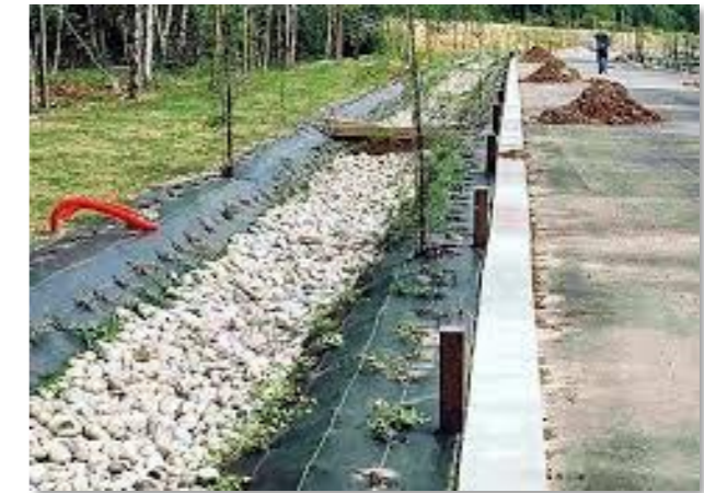
Noue plantée et filtrantes (sols imperméables)
